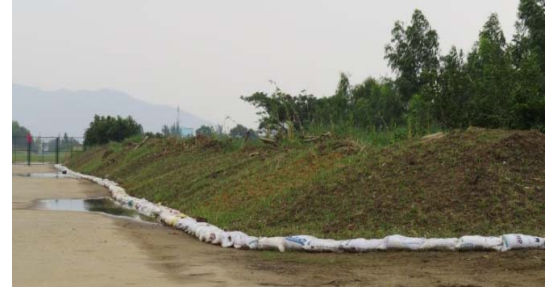
Bãi tập kết chứa khoảng 250 m 3 chất liệu đất mặt sạch, đang được ủ làm phân hữu cơ (Ảnh: CDM Smith)
