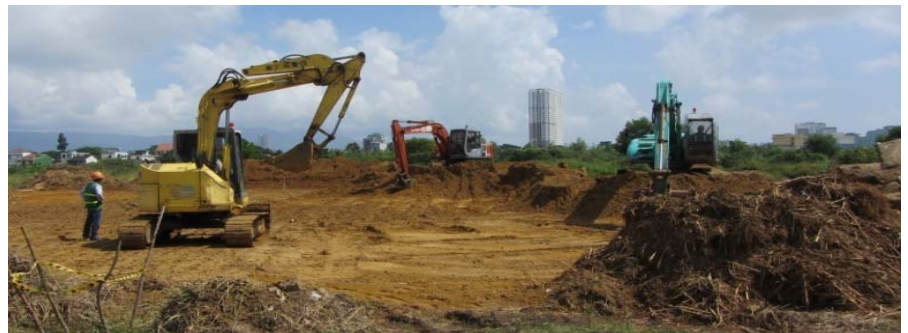
Phát quang và san nền cho vị trí của mô xử lý khử hấp thu nhiệt
